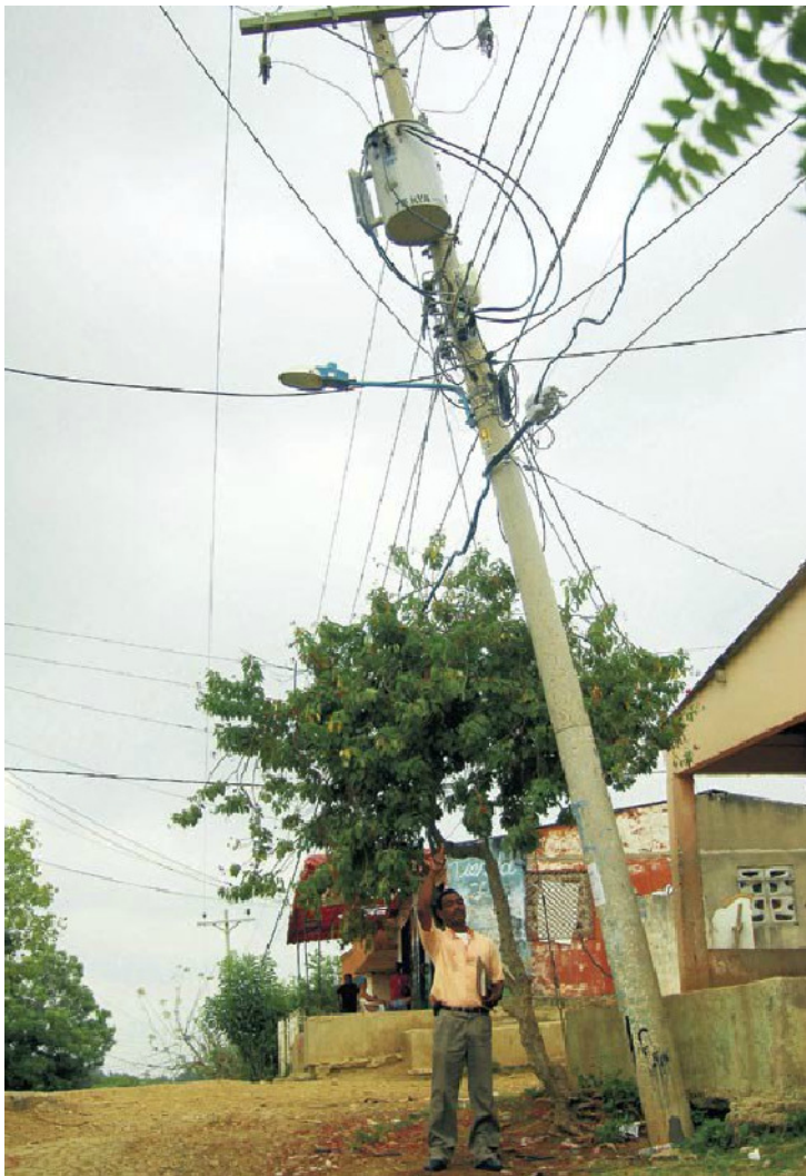
En el sector Bella Vista los postes de electricidad están torcidos y son un peligro para los habitantes, quienes además se quejan de inestabilidad en el voltaje. FOTO: ARCHIVO/
